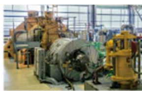
揚水発電機の温度・歪モニタ
